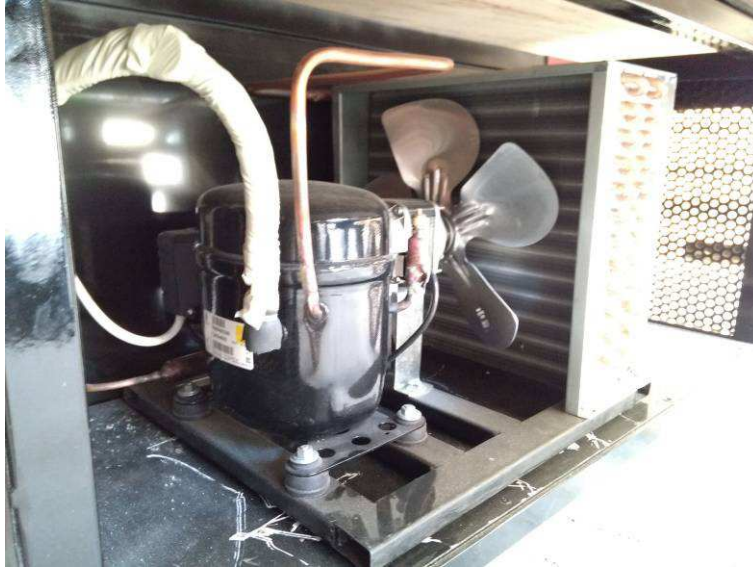
Soğutma Ünitesi Görünüm / Cooling Unit View
